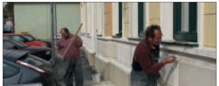
Erst vor fünf Jahren wurde die Fassade des Gemeindeamtsgebäudes renoviert. Im Herbst musste wieder nachgebessert werden. Den Gemeindearbeitern geht die Arbeit nie aus.
