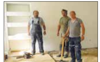
Foto von der Sanierung des Bewegungsraumes der VS Mühlbach. Der durch auftretende Feuchtigkeit verursachte Schaden im Turnsaal der Volksschule Mühlbach wird saniert. In Zusammenarbeit mit der Baufirma Schuster verrichten die Gemeindeglieder die Trockenlegungs-, Estrich- und Maurerarbeiten. Im Anschluss wird der Bodenbelag verlegt.
